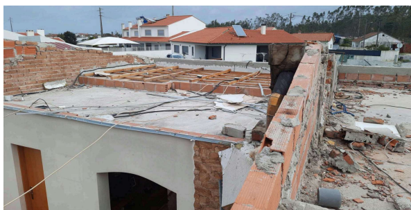
Habitação danificada pela Tempestade Kristin
